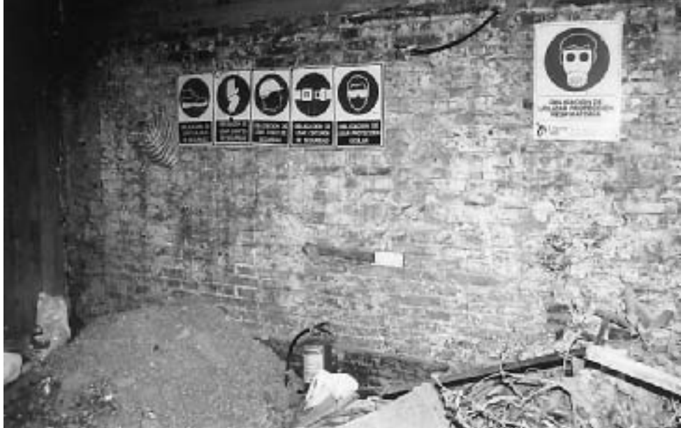
Carteles indicadores de las medidas de seguridad que deben acatarse en la obra.
