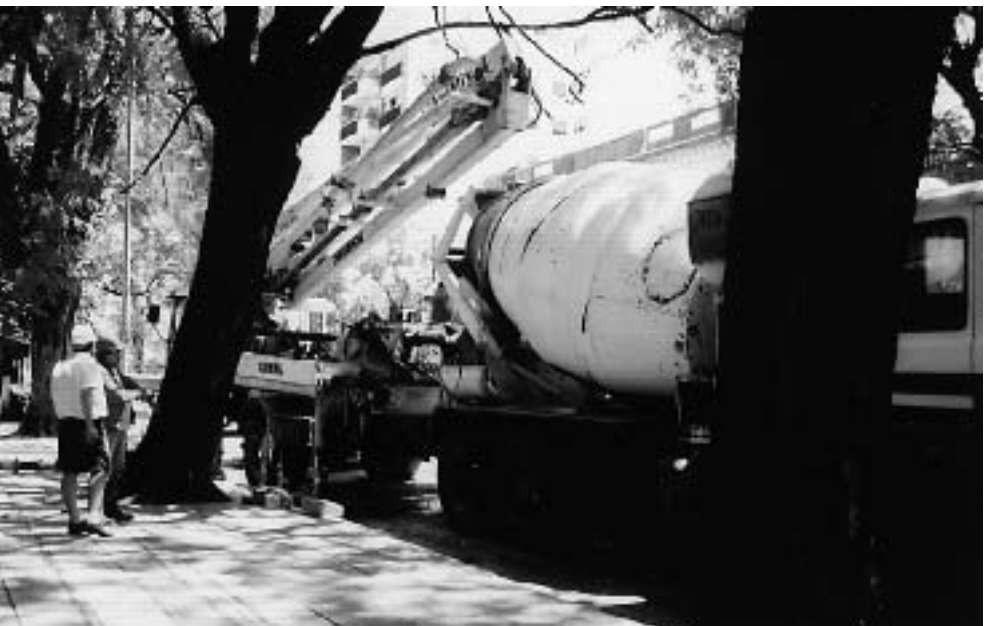
Día de la hormigonada. Detalle de camión con trompo y brazo de la bomba.
